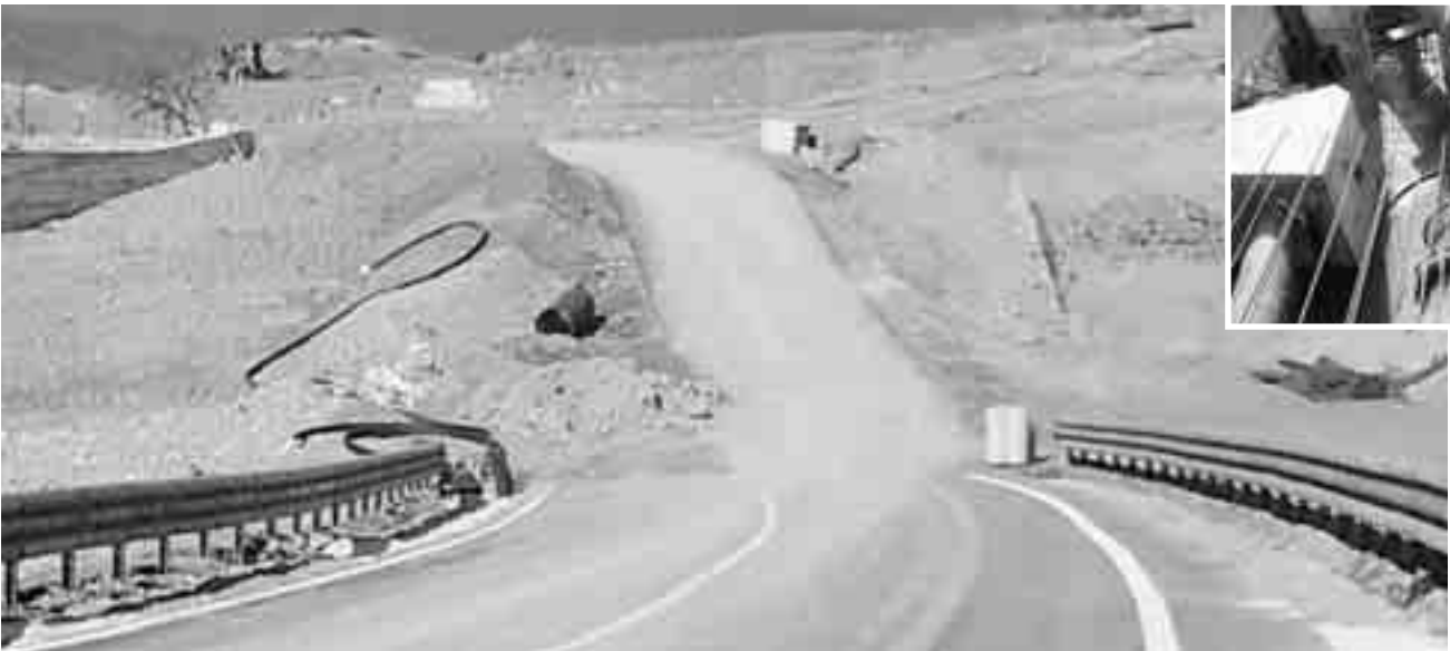
I lavori della Ss 284 e in alto nella foto la condotta che sarà tagliata per essere innestata nella nuova tubazione già realizzata sotto la Statale
