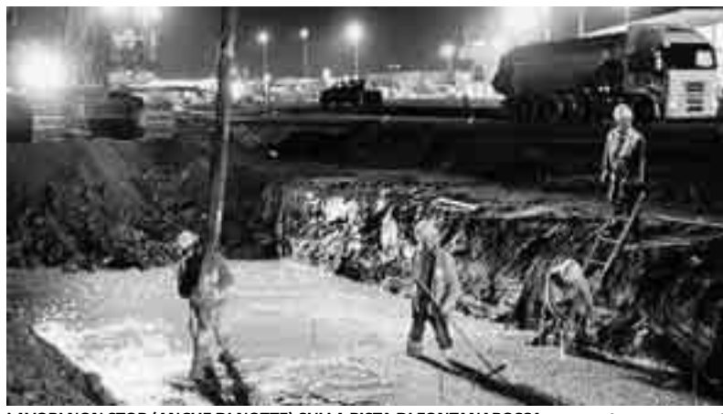
LAVORI NON STOP (ANCHE DI NOTTE) SULLA PISTA DI FONTANAROSSA [FOTO PARRINELLO]
